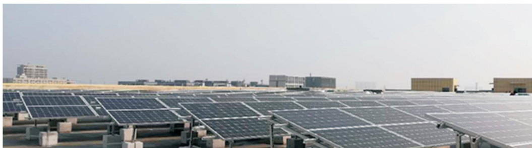
人民（武汉）国际汽车城屋顶光伏电站 装机容量：2MW
