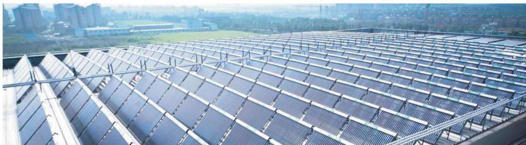
浙江晨泰集团屋顶光伏电站 装机容量：3MW
