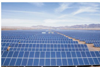
大型集中式光伏电站系统
