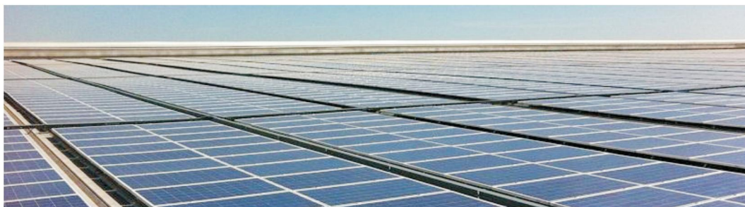
山东玉昊隆集团屋顶光伏电站 装机容量：3MW
