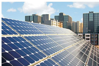
BAPV建筑 屋顶上安装的发电系统
