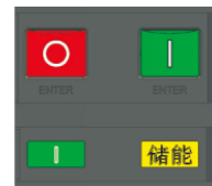
断路器合闸且已储能完毕状态
